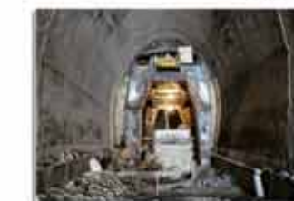
● راه آهن اراک - کرمانشاه طول پروژه ۱۱۲ کیلومتر، شامل ۱۰ پل بزرگ، ۵ تونل و ۸ ایستگاه / جاری
